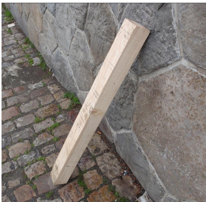
Obr. 3 Odpadnutý dřevěný trámek o rozměrech 1m x 0,1m x 0,1m
