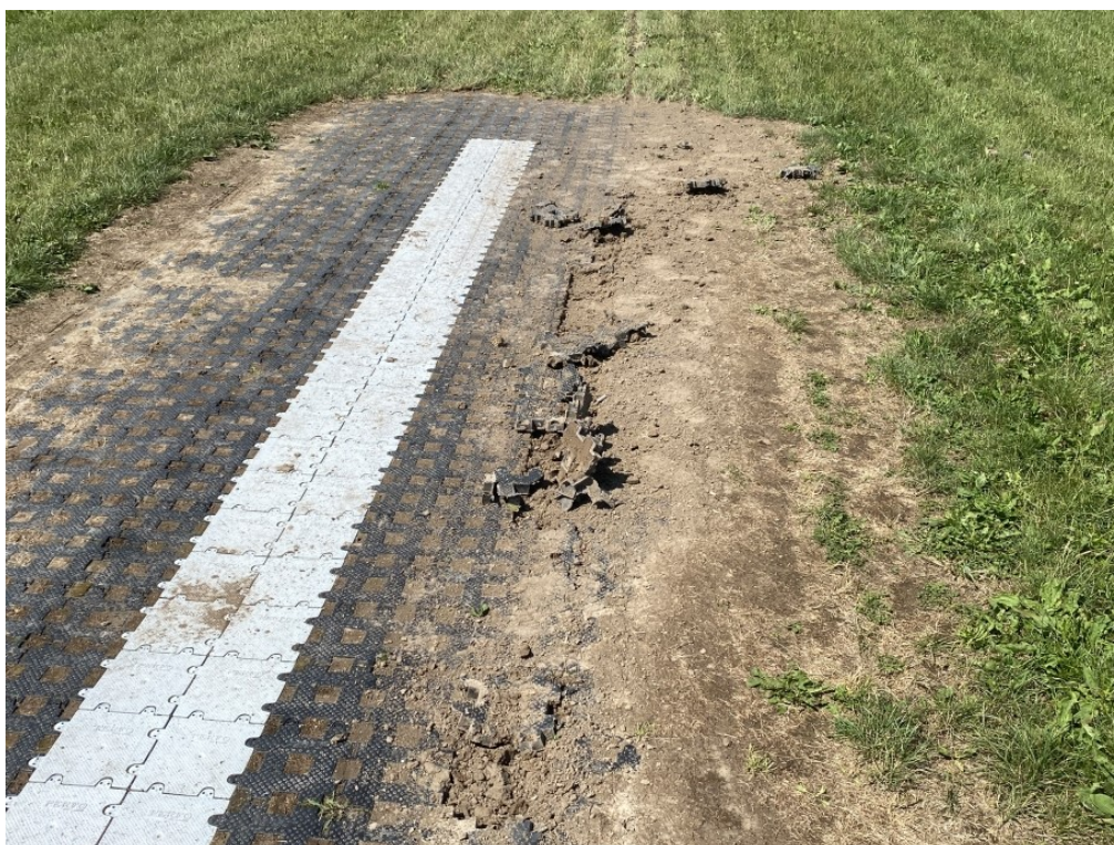
Obr. 4 – Poškození zpevněného povrchu dráhy vpravo od osového značení.
