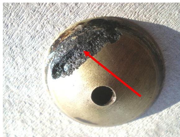
Koroze z vnitřní strany záslepky.
